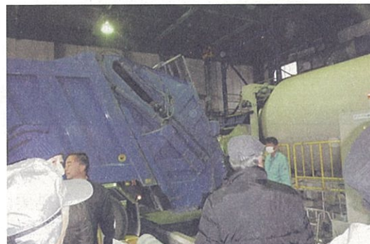
大型パッカー車からのごみの受入状況
