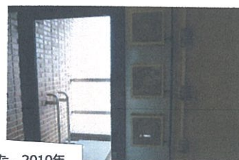
図2 換気扇3台を設置した喫煙室の内部
