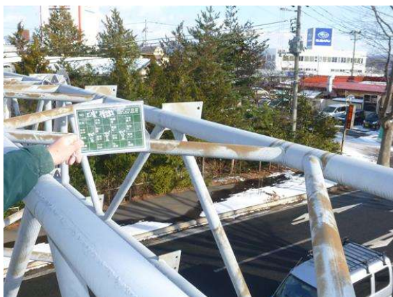
(防食機能劣化)
