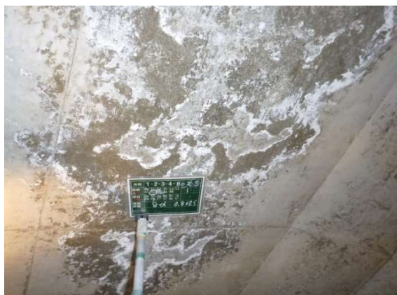
(遊離石灰・漏水)
