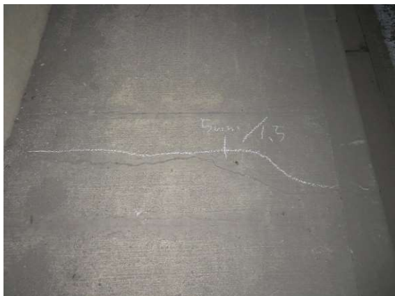
(コンクリートのひびわれ)
