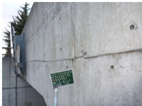
(コンクリートのひびわれ)
