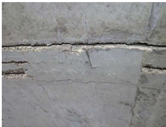
(コンクリート剥離・うき)
