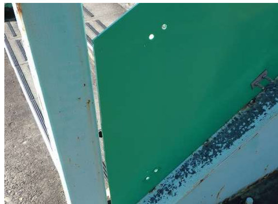
(ボルトの脱落 [高欄部])
