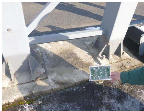
(コンクリートひび割れ)
