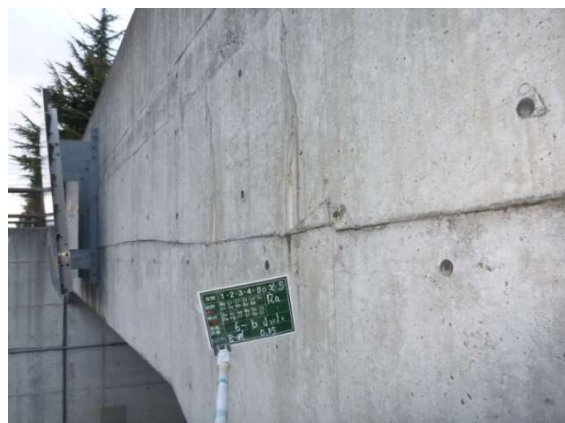
(コンクリートのひびわれ)
