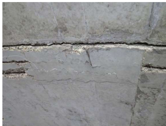
(コンクリート剥離・うき)
