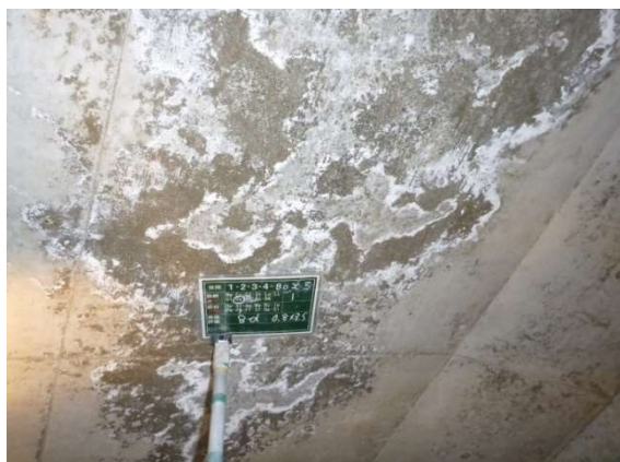
(遊離石灰・漏水)
