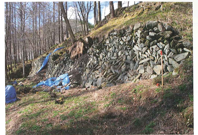
崩落した岩手県指定史跡栗木鉄山跡の石垣(気仙郡住田町世田米字子飼沢地内)
