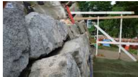
20cm以上の段差が生じている（東側）
