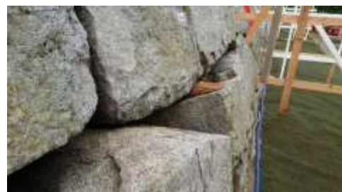
20cm以上の段差が生じている（西側）
