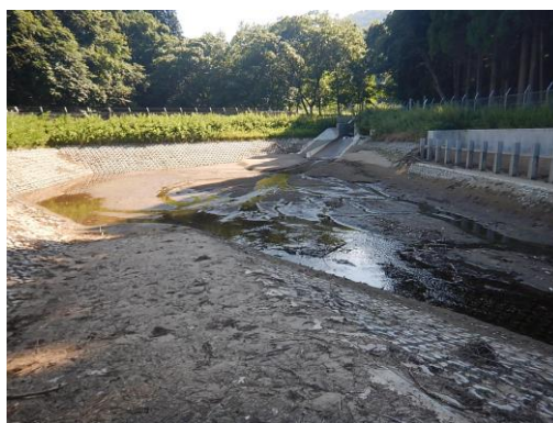
図 3. 7 沈砂池の土砂堆積状況
