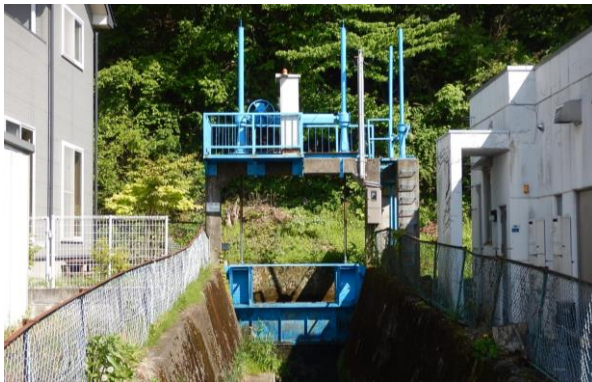
河－5 (堰上・電動)
