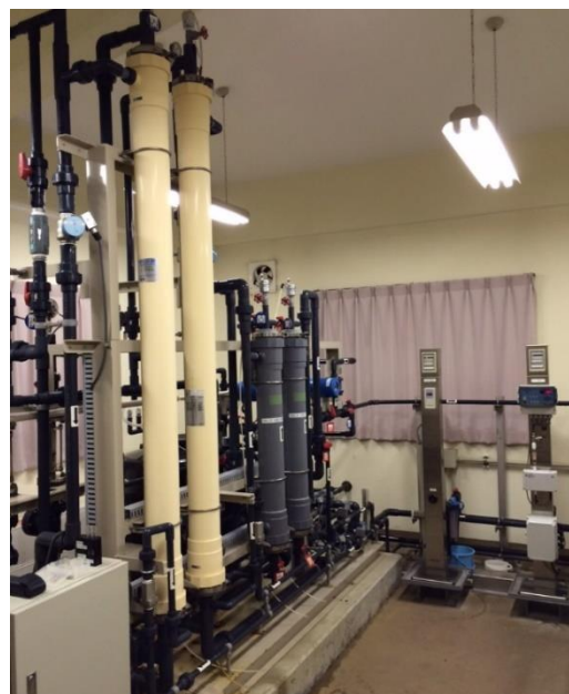
浄水処理設備
