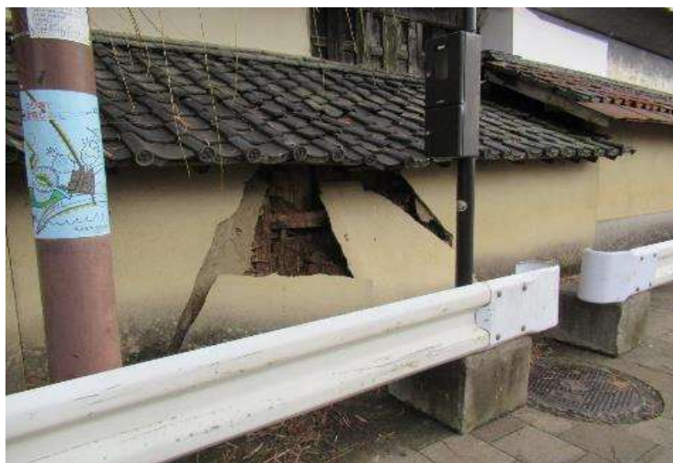
莫蔭九破損箇所(拡大)
