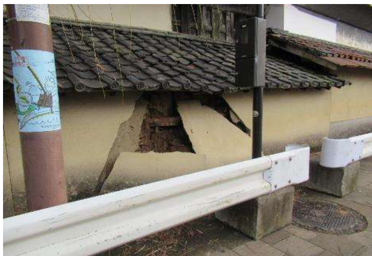
莫蔭九破損箇所(拡大)
