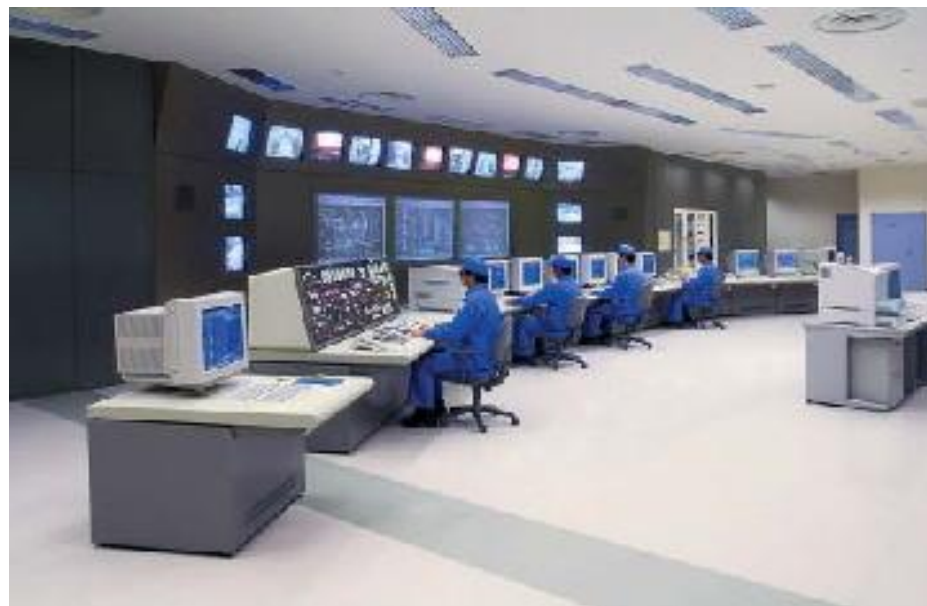
ごみ焼却施設の中央制御室
