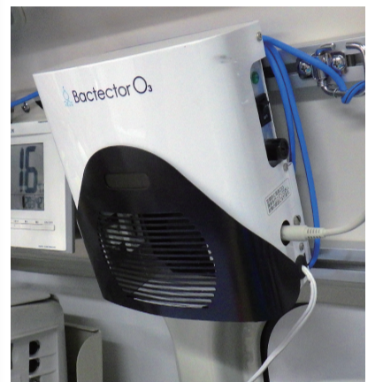
設置検討中のオゾンガス発生装置
