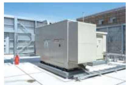
管理棟専用非常用発電機
