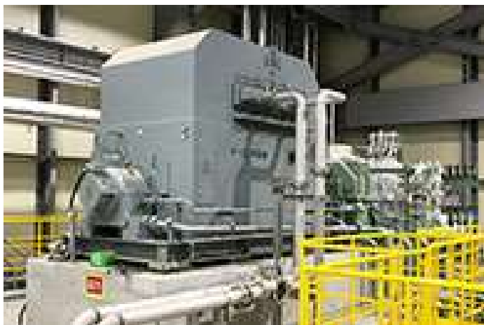
蒸気タービン発電施設
