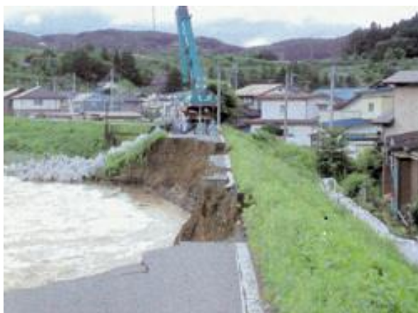
平成 14 年台風第 6 号による築川の被害状況
