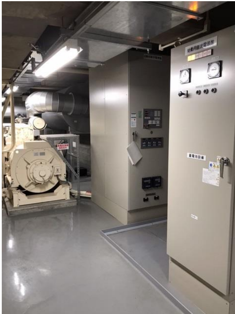
(盛岡市の現状) 自家発電設備は地下にあ るため浸水時に対応不可
