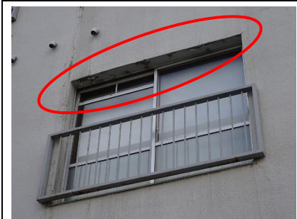
北面外壁 転落防止柵サビ、塗装剥離
