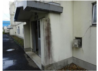
西面外壁 流水汚れ
