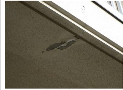
南面外壁 ひび割れ・塗装剥離
