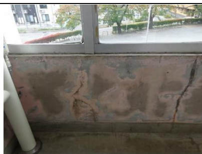
階段室壁面 ひび割れ
