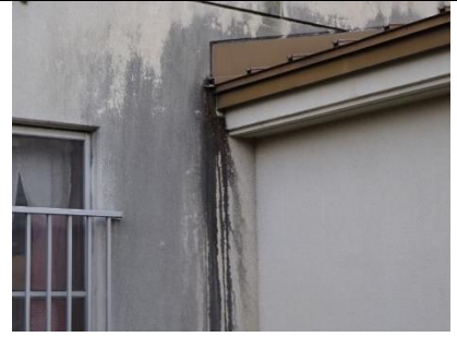
北面外壁出入口屋根周辺 雨水跡
