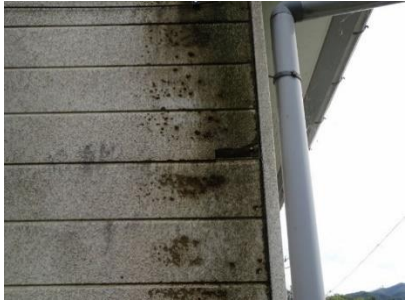
西面外壁 劣化
