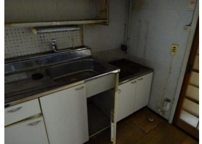
台所壁面 汚れ
