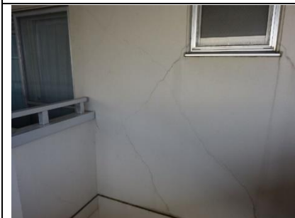
共用廊下壁面 ひび割れ
