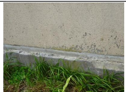
南面外壁基礎部 破損
