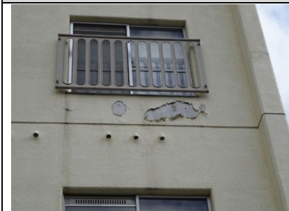
西面外壁 塗装剥離
