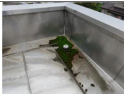
屋上 コケあり
