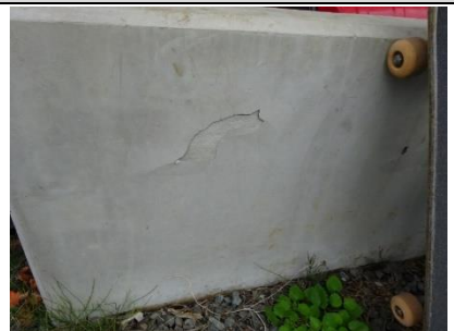
テラス下部壁面 上塗りモルタル剥離
