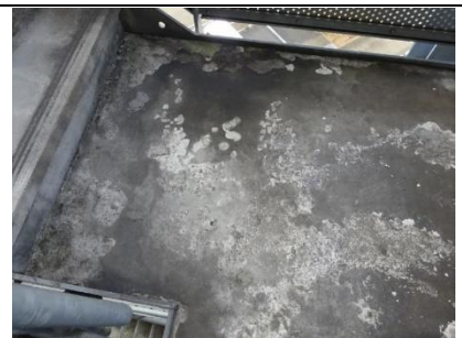
屋外階床面目 劣化
