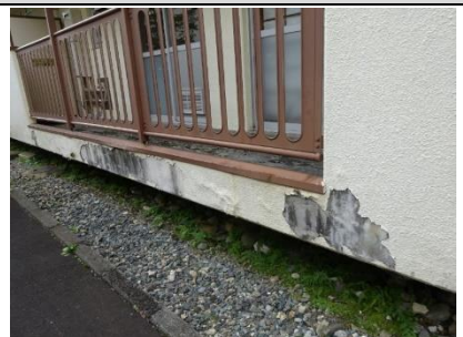
東面外壁 塗装剥離
