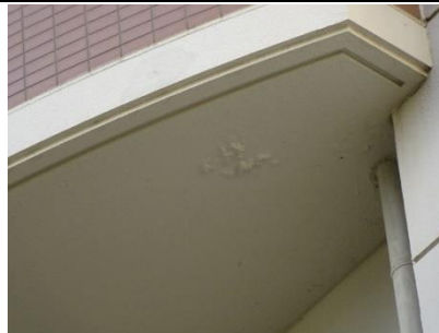
南面外壁 塗装の膨れ
