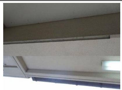
出入口庇天井 破損・欠落
