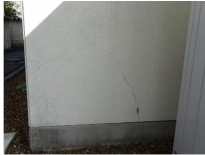
南面外壁 ひび割れ
