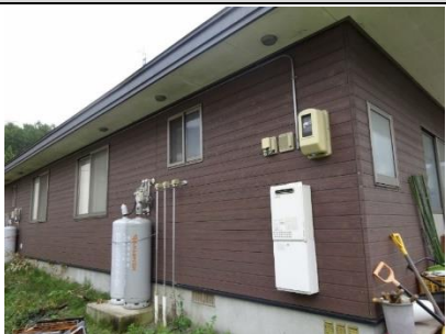
北面外壁軒下 劣化
