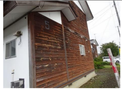
5号棟外壁 色褪せ
