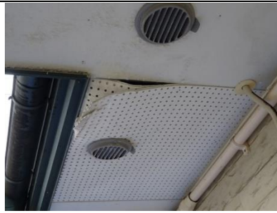
北面外壁軒裏 ボード剥離
