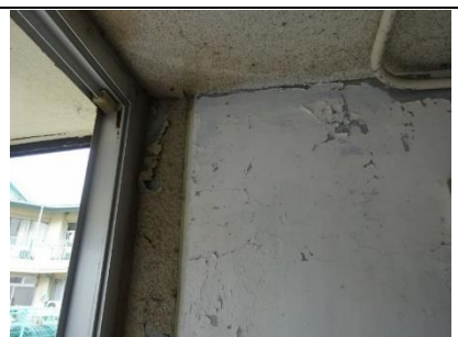
階段室壁面 塗装剥離
