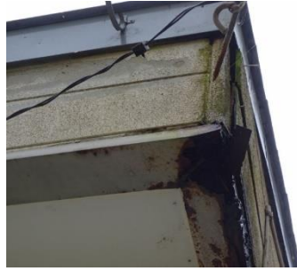
西面外壁軒下 腐食・破損
