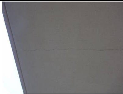
廊下天井 ひび割れ
