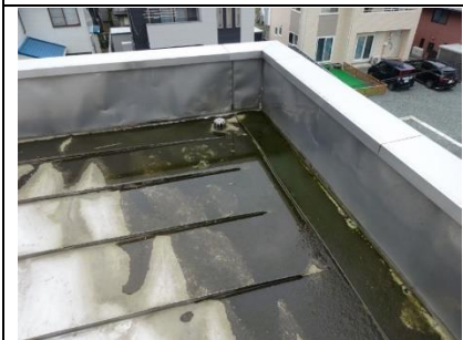
屋上 滞水あり
