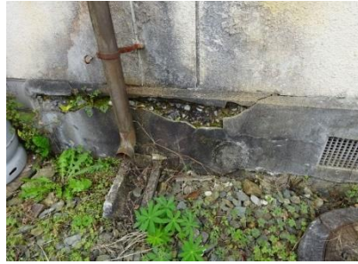
北面外壁基礎 破損
