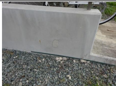
スロープ壁面 上塗りモルタル剥離
