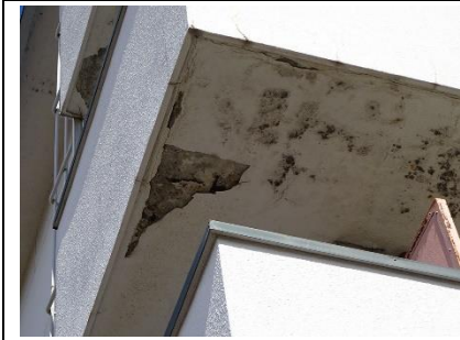
南面外壁 ベランダ天井塗装剥離
