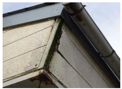
東面外壁庇 ひび割れ
