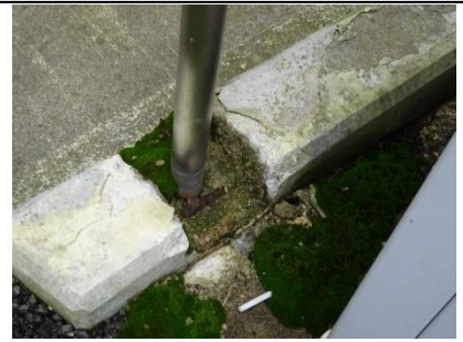
スロープ手すり基礎 鉄筋露出
