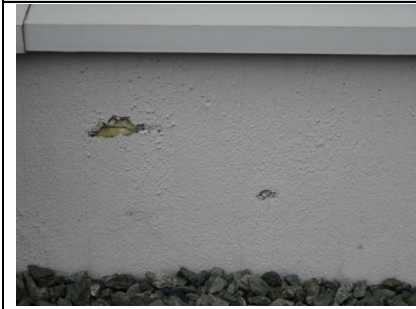
南面外壁基礎部 外断熱材損傷
