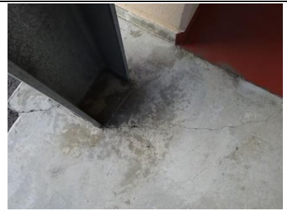
屋外階段床 ひび割れ
