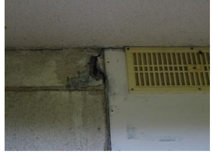
南面外壁 鉄筋露出
