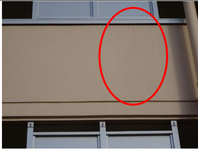
西側外壁 ひび割れ
