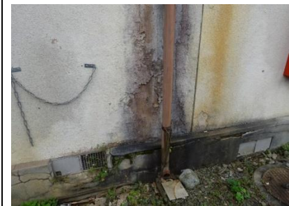
北面外壁 塗装剥離・変色
