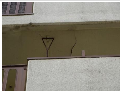
東面外壁 塗装剥離
