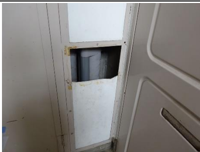
階段室パイプスペース 破損
