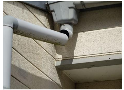
雨水排水管 接合部ズレ
