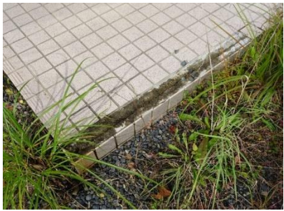
東面外壁出入口 破損
