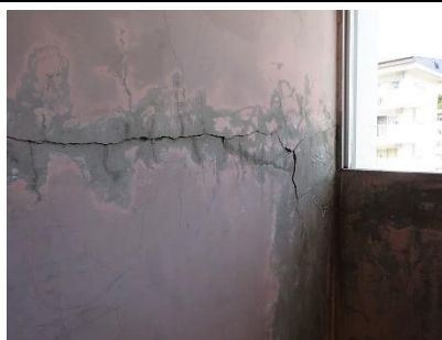
階段室踊り場 壁ひび割れ、塗装剥離
