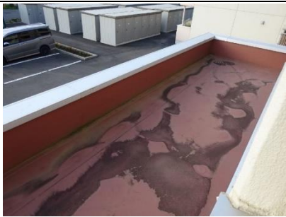
出入口屋根 滞水跡あり
