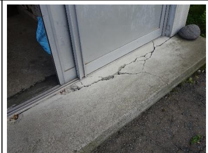
北面階段室入口 ひび割れ
