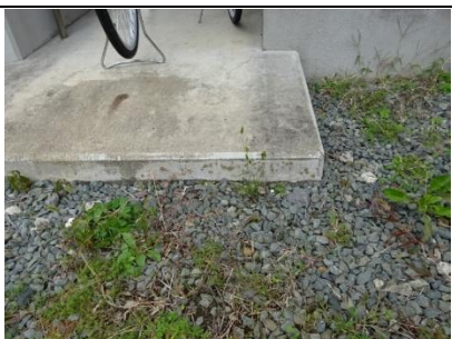
スロープ入口 段差あり
