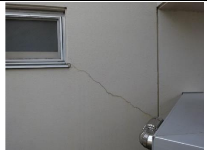
共用廊下壁面 ひび割れ
