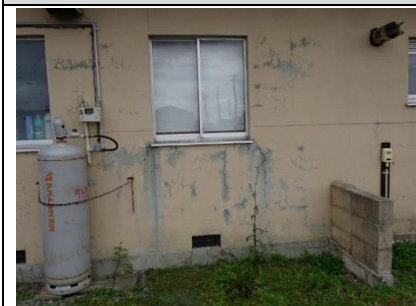
北面外壁 ひび割れ・剥離
