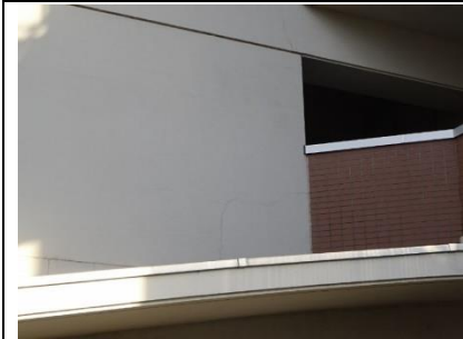
北面外壁 ひび割れ
