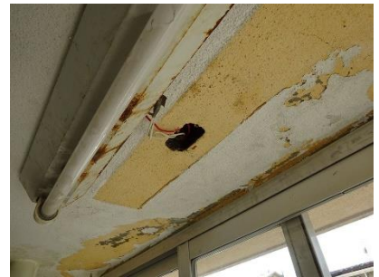
階段室入口 天井塗装剥離
