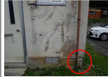
北面外壁基礎 鉄筋露出
