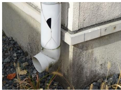
雨水排水管 破損
