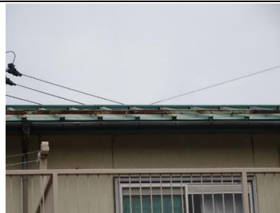
南面外壁 雪止めサビ
