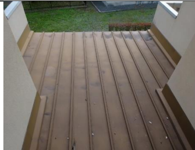
出入口庇屋根 退色・滞水跡
