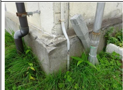
西側外壁 基礎破損
