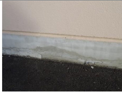
西側外壁 化粧モルタル剥離
