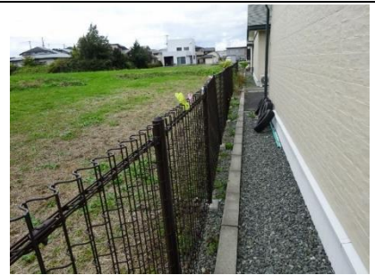
敷地境界柵 変形
