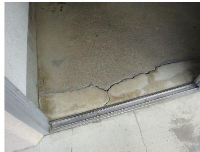
階段室入口 コンクリートひび割れ
