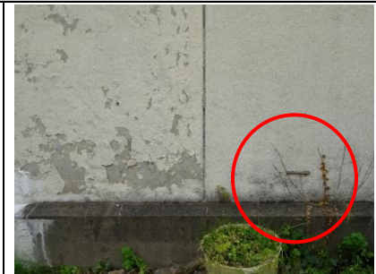
西側外壁 鉄筋露出
