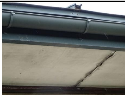
北面外壁軒裏 ボード隙間あり
