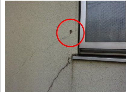
西面外壁 鉄筋露出・ひび割れ
