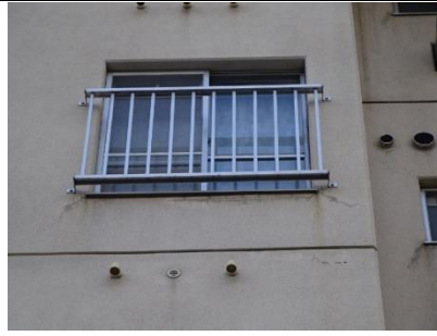
北面外壁窓枠 ひび割れ（八の字）
