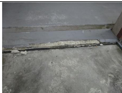
屋外階段継ぎ目 破損
