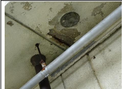
北面外壁 鉄筋露出
