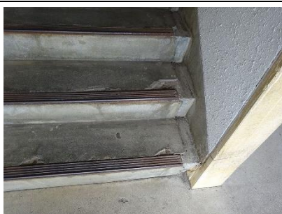
階段室 階段滑り止め金物 サビ
