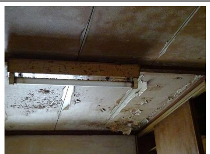
住戸内 台所天井劣化
