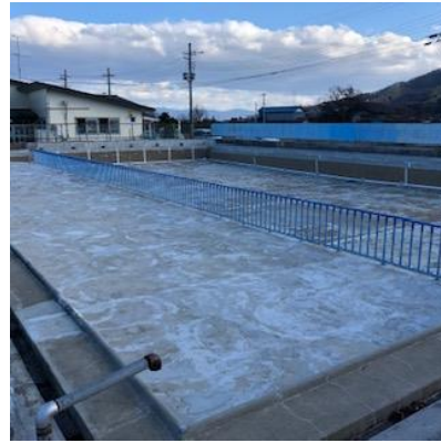
▲プール槽の劣化（遠景２）
