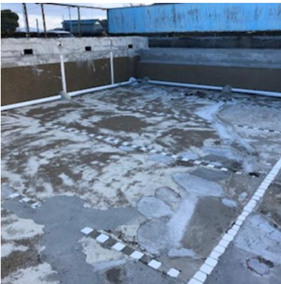
▲プール槽の劣化（近景１）
