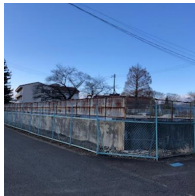
▲基礎コンクリートの劣化
