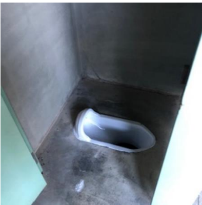
▲老朽化したトイレ１
