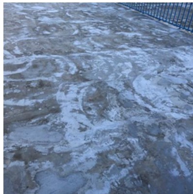
▲プール槽の劣化（近景２）
