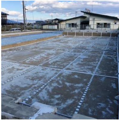
▲プール槽の劣化（遠景１）
