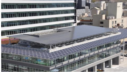
(屋上太陽光発電 出典：甲府市公式 HP)
