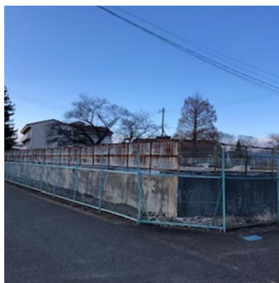
▲基礎コンクリートの劣化
