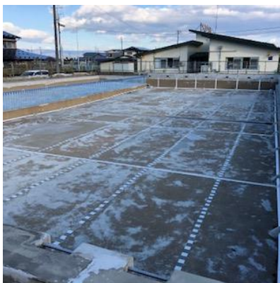
▲プール槽の劣化（遠景1）
