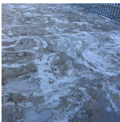
▲プール槽の劣化（近景2）
