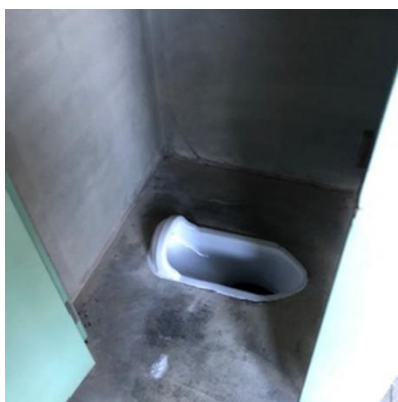
▲老朽化したトイレ1
