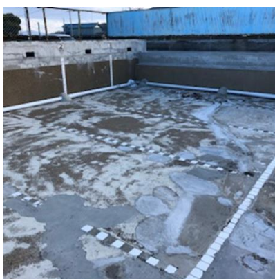
▲プール槽の劣化（近景1）
