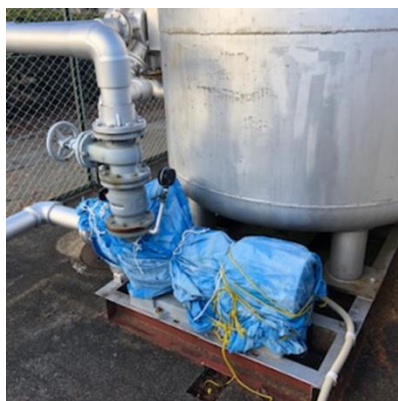
▲応急処置されたろ過設備 （屋外に設置）
