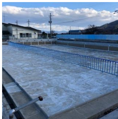
▲プール槽の劣化（遠景2）
