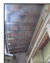
垂木・野地板の腐食
