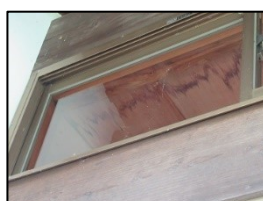
天井まで雨漏り
