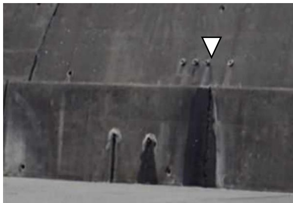
地下水の流出
