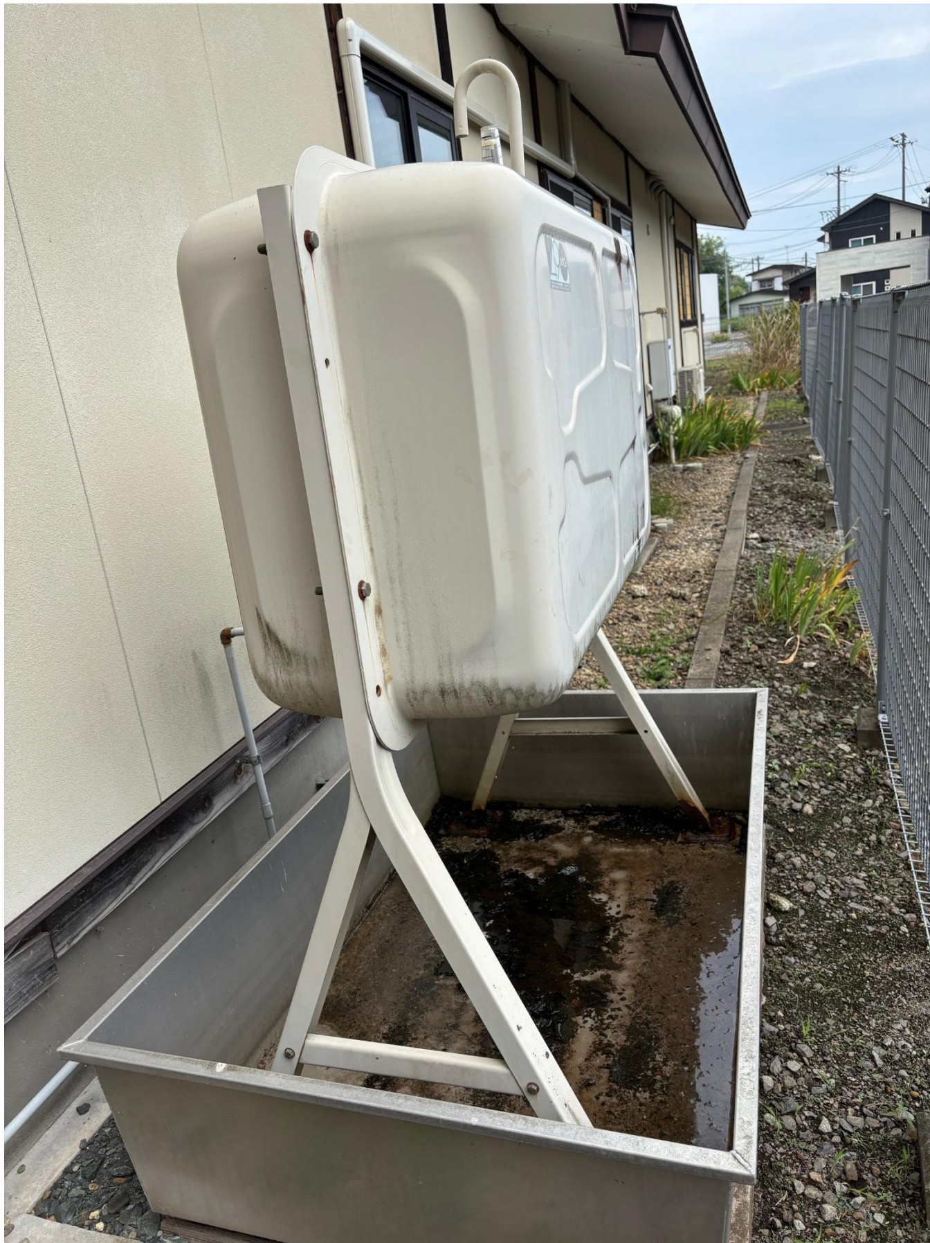
(オイルタンク)
