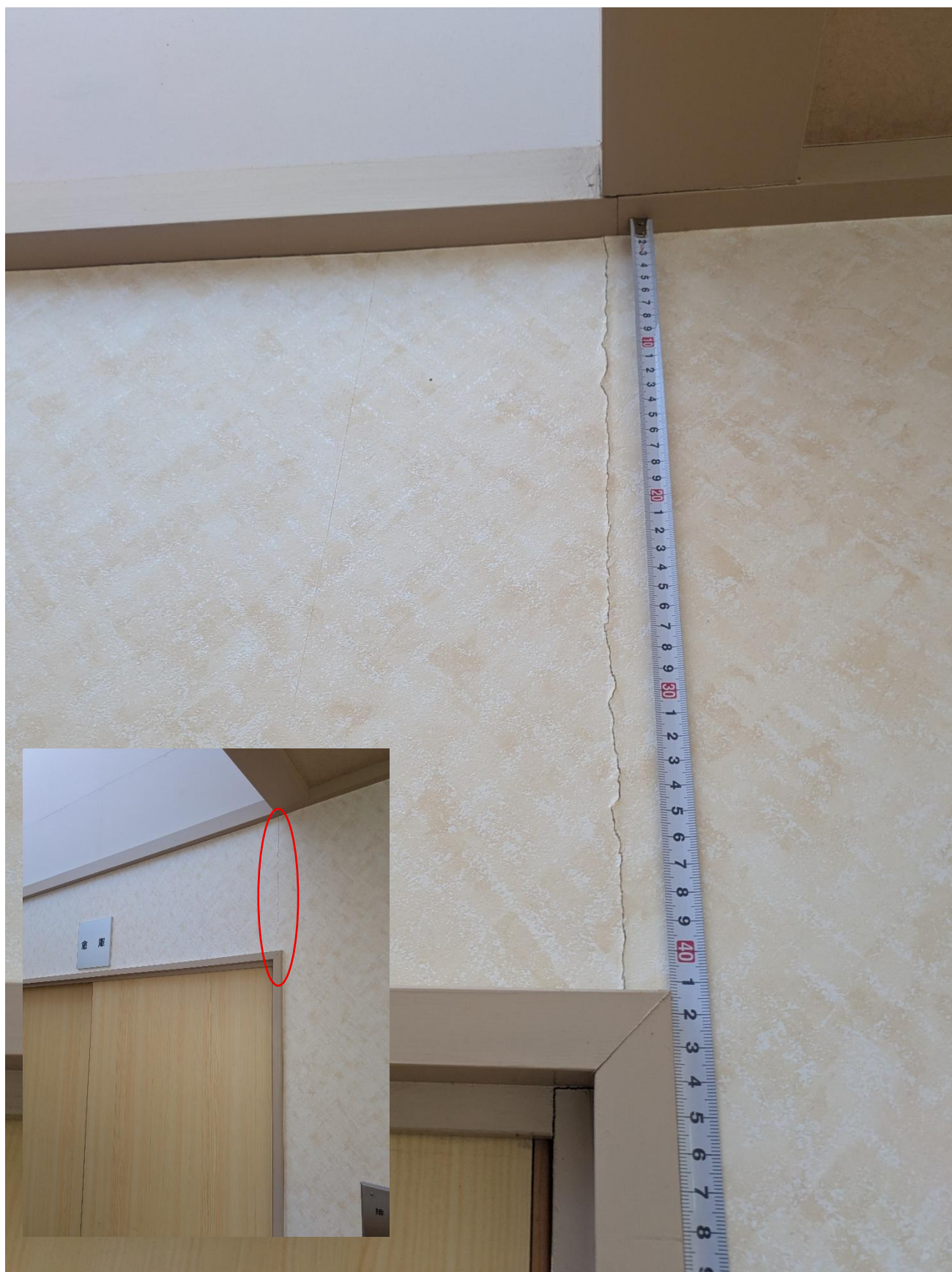
天窓内壁クロス
