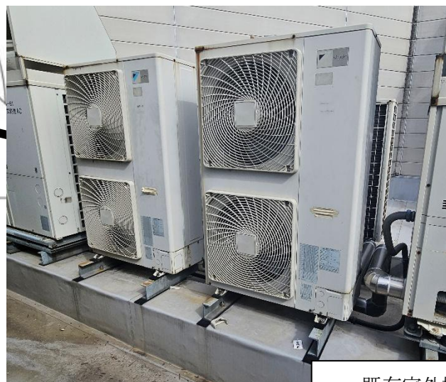
既存室外機 2台
